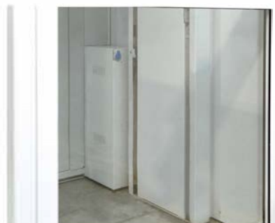
Шкаф управления внутри ограждения
